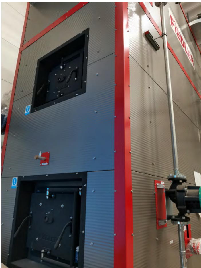
Výkonný kotel, který bude mít na starosti výhřev sušárny a vytápění hlavní haly pilařského závodu
